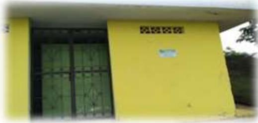
Batería sanitaria Comunidad La Boca
