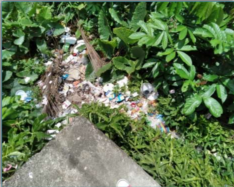
Botadero de basura sobre el Puente metálico en el barrio La Travesía; de la cabecera parroquial
