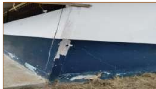
estragos del terremoto en la escuela de la comunidad la Boca
