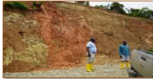
Deslizamiento de cerros en las vías
