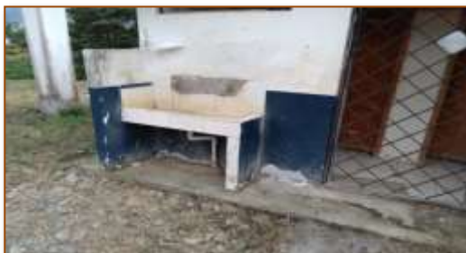
Paredes de la escuela del encanto con fisuras
