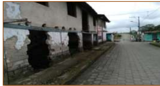
Casas de construcción mixta abandonadas
